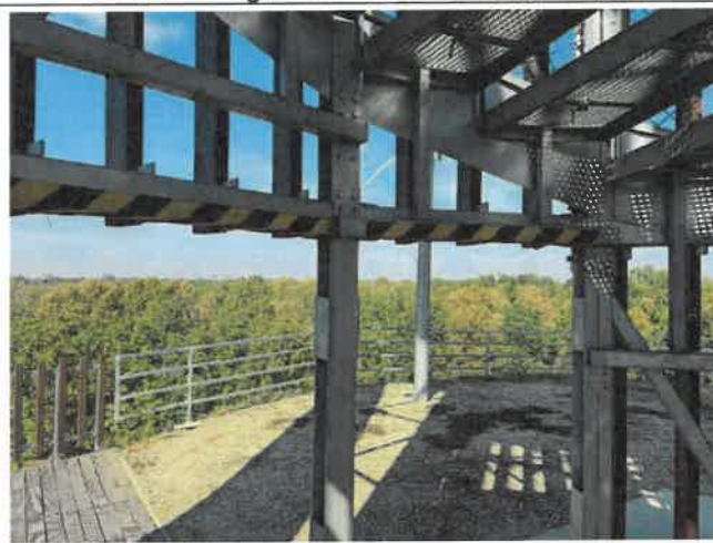
F04- Bejárat acélszerkezeten figyelemfelhívó jelzés
